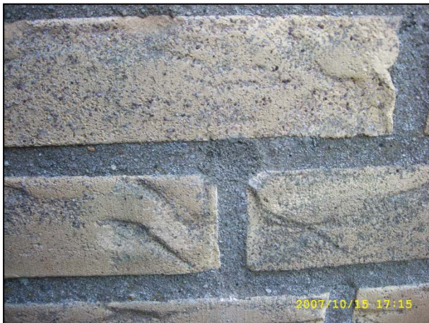
Afb. 3 Boorgat in de gevel
