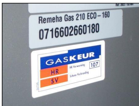
Afb. 9 CV-ketel met HR keur (HR107)
