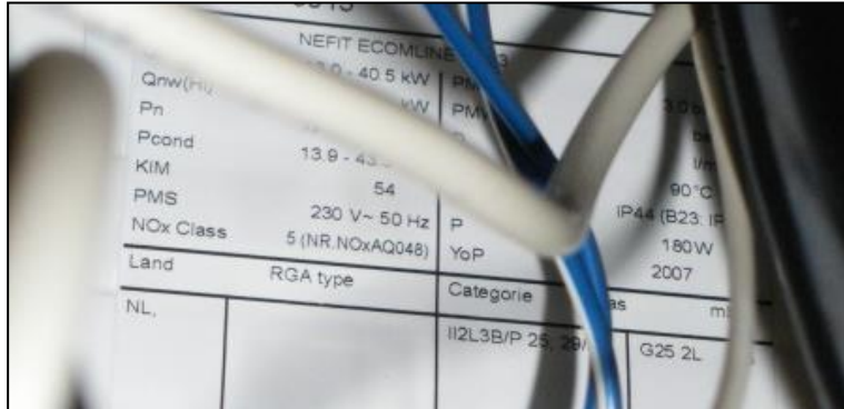
Afb. 10 Typeplaatje CV-ketel met bouwjaar 2007 (YoP = Year of Production)
