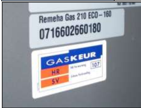
Afb. 9 CV-ketel met HR keur (HR107)
