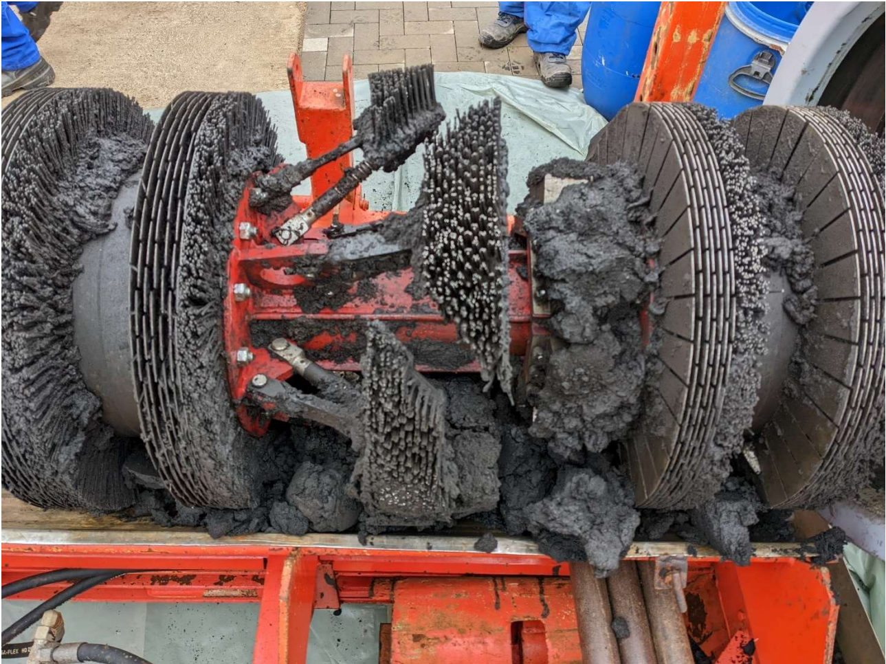
Abbildung 10: Ablagerungen aus einer Transportpipeline, zweite Reinigungsmolchung
