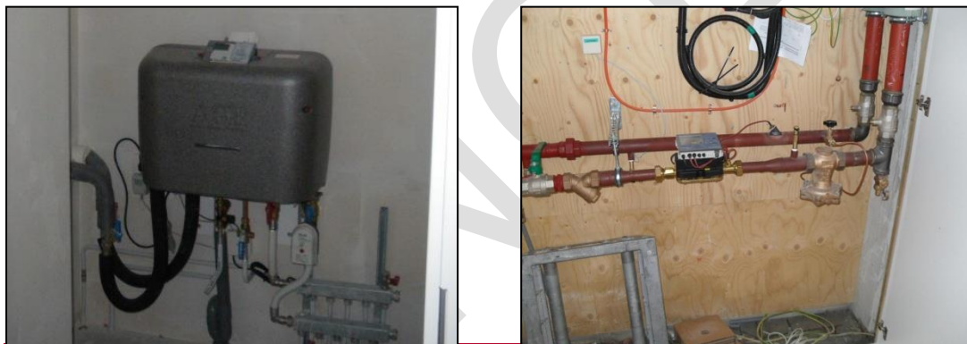
Afb. 11 a. Stadsverwarmingsunit (tevens tapwater) — b. Secundaire stadsverwarmingsaansluiting (alleen CV)
