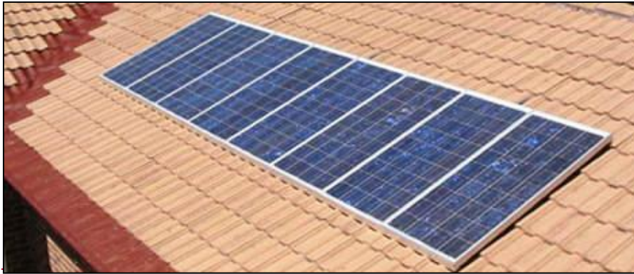
Afb. 16 PV panelen met afmeting van ongeveer 1,55 x 0,80 m (4,5 pan hoog, 4 pannen breed) Facturen, documenten en rapporten
