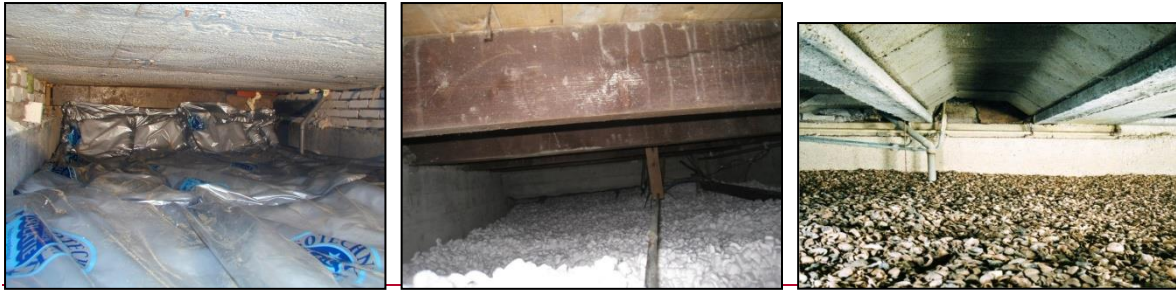
Afb. 8 Isolatie in de kruipruimte, met respectievelijk isolatiedekens, parels en schelpen Foto's
