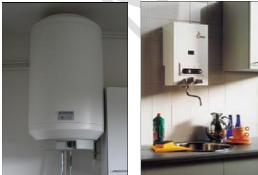
Afb. 12 Elektrische boiler (links) en geiser (rechts)
