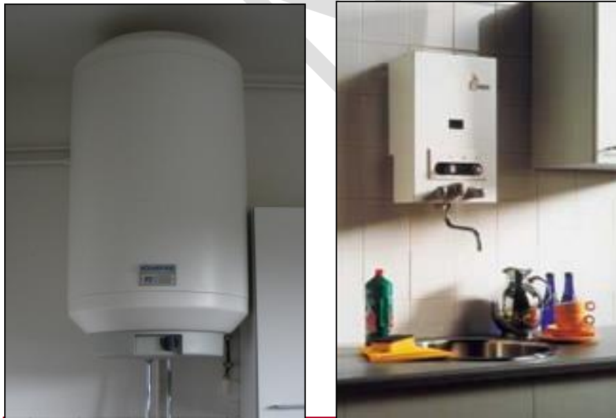
Afb. 12 Elektrische boiler (links) en geiser (rechts)
