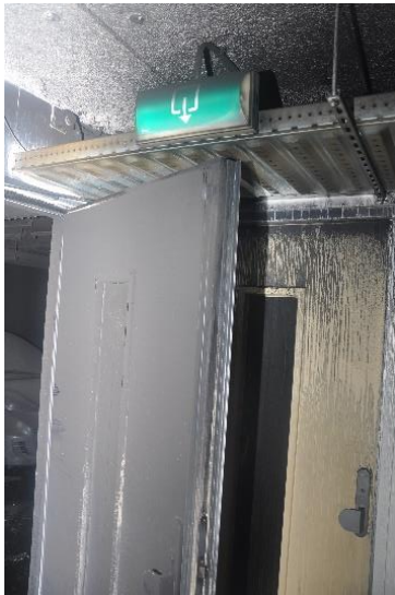
Foto 6: Brandwerende deur tussen parkeerkelder en trappenhuis.
