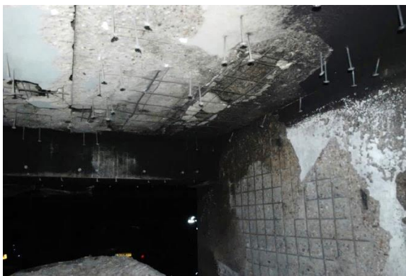
Foto 22: Afgespat beton met blootliggend betonijzer.
