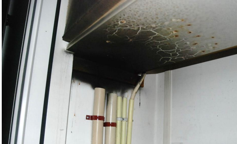
Foto 24: Loze leidingen in de bovenliggende meterkast.
