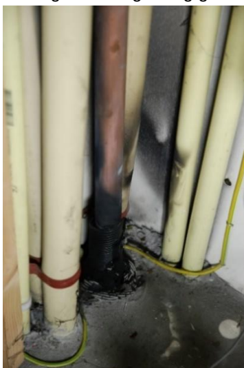
Foto 9: Verkooldde mantelbuis in meterkast direct boven vuurhaard.
