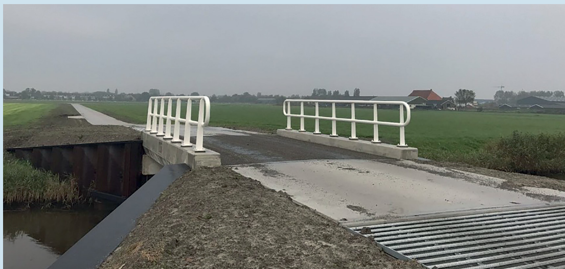
Figuur 19: De omleidingsweg die is aangelegd om de overweg in de Oude Trekweg in Harlingen op te kunnen heffen. De overweg bevond zich rechts van het rode dak op de foto. (Foto: ProRail)
